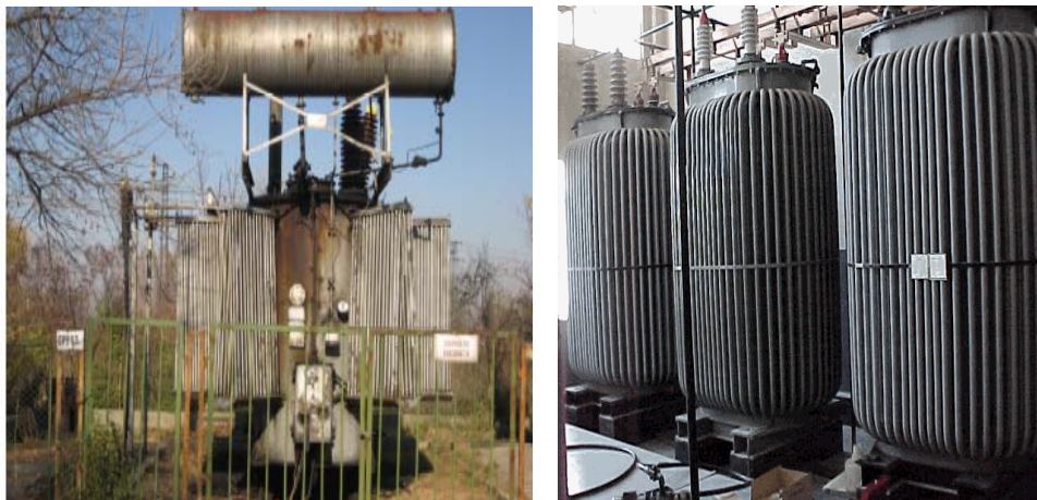
Снимка 1: Трансформатори в експлоатация, съдържащ РСВ, експлоатиран в България
