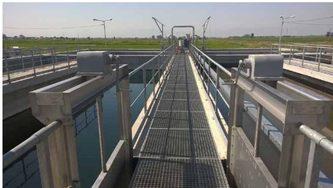
Пречиствателна станция на гр. Раковски Treatment Plant in the town of Rakovski
